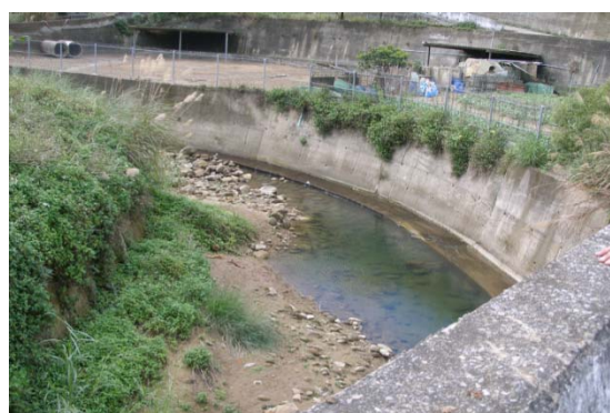
圖一 護岸基礎被沖蝕
